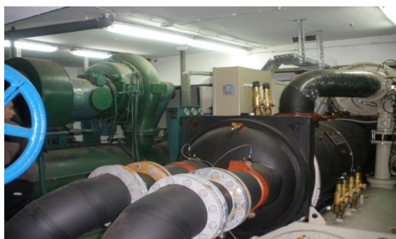
Slika 30.- Zamjena rashladnog agregata - ušteda oko 25.000 kn/godišnje.
